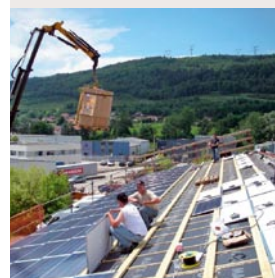
Foto: Sopro Energies
